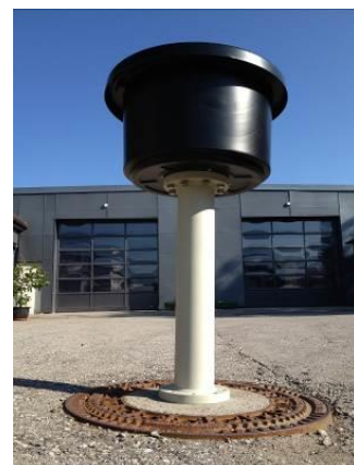
Passive Entlüftung des Kanals
