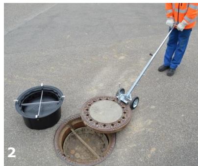
Schachtabdeckung mit passendem Schachtdeckel- heber entfernen
