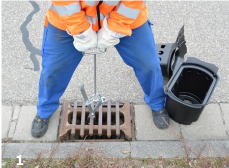
1 Schachtabdeckung mit passendem Schachtdeckel- heber entfernen
