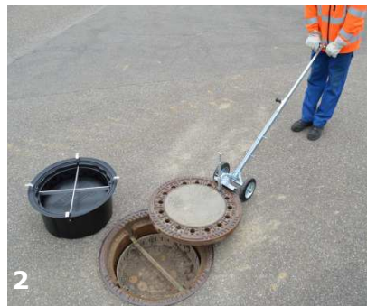
Schachtabdeckung mit passendem Schachtdeckel- heber entfernen
